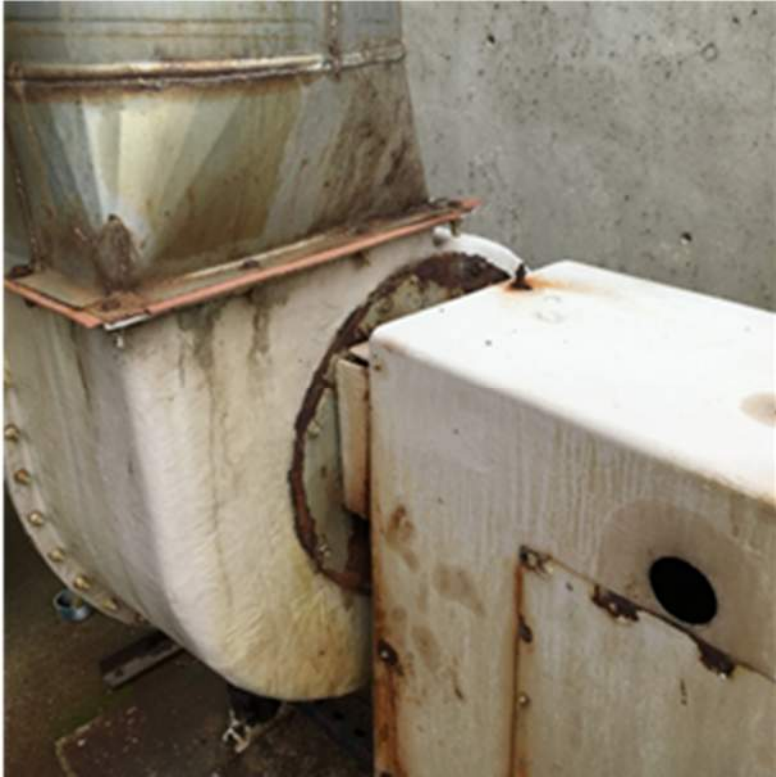
Photo 7: Odor Control Fan
