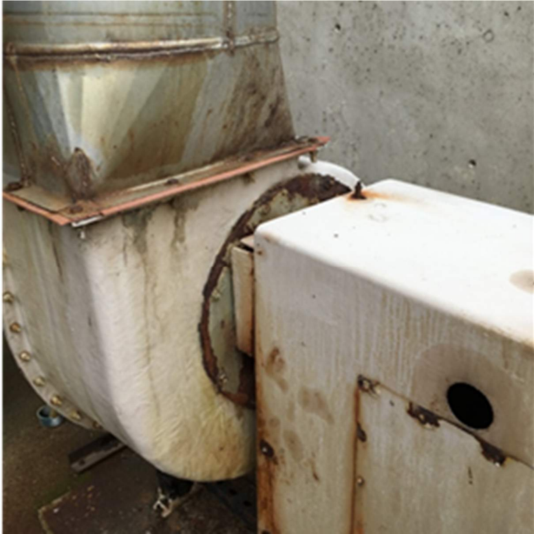
Photo 7: Odor Control Fan
